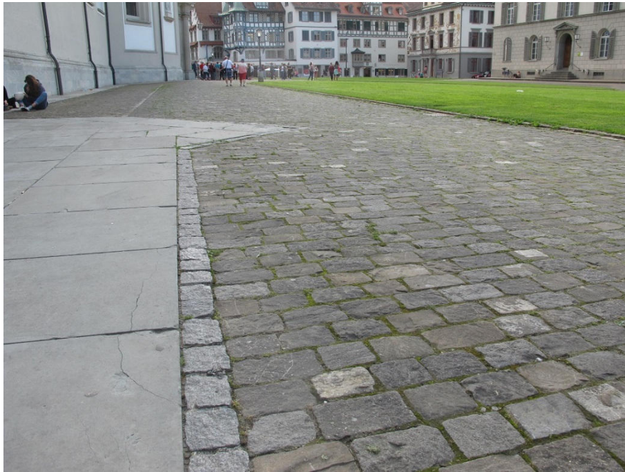
Bild 1: Klosterhof, St. Gallen: suboptimales Kopfsteinpflaster für Gebehinderte, Rollstühle und Kinderwagen
