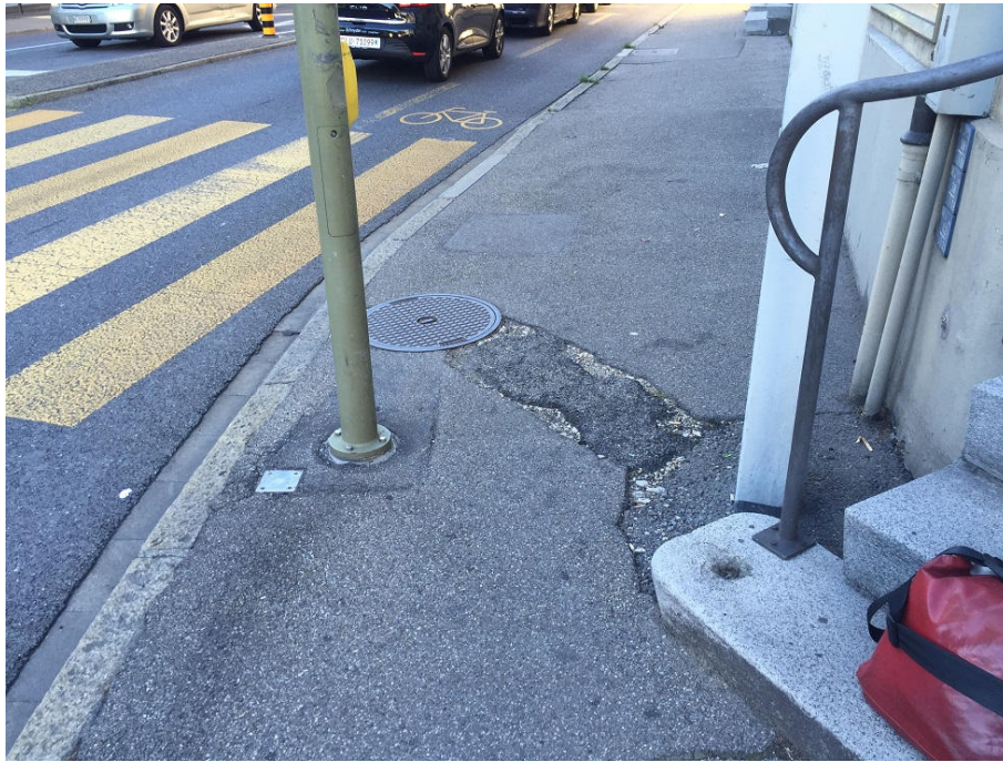
Bild 19: Querung Ländtestrasse, Biel: viel zu kleiner Warteraum mit störendem Lichtmast und Stolperfallen wegen Belagsschäden
